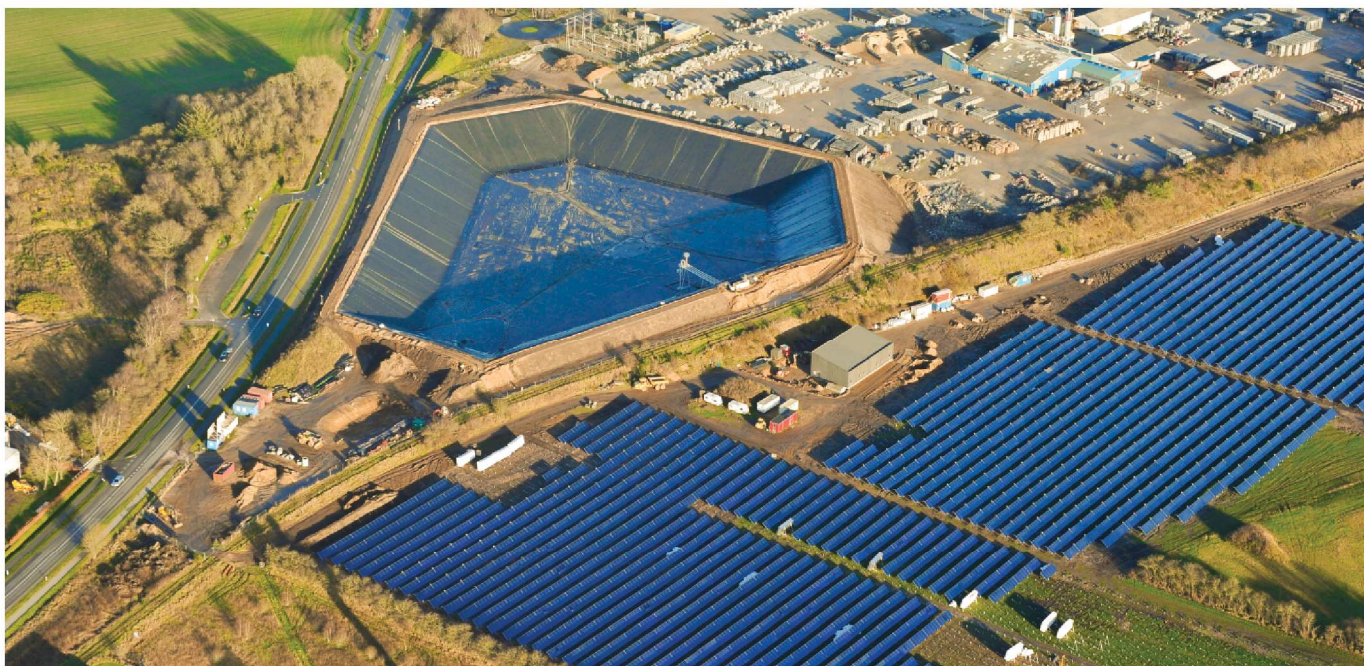
Groplager under konstruktion i danska Vojens med ett solvärmefält på 70 000 m 2 . Foto Arcon-Sunmark.
